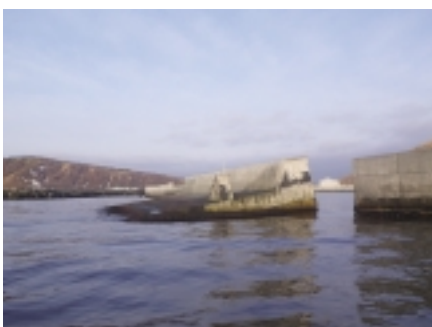
高波による防波堤損壊（鷺泊港）
